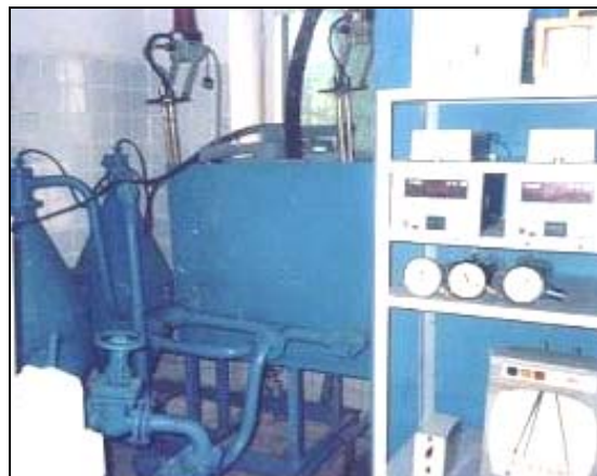
Рис. 5. Зовнішній вигляд автоматичної насосної станції
